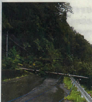
倒木による電柱折損
